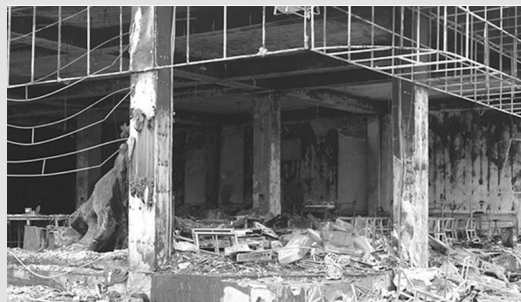
● Công trình xảy ra vụ hỏa hoạn không đảm bảo quy chuẩn an toàn phòng cháy, chữa cháy.
