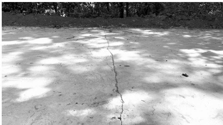
● Vết nứt xuất hiện tại đoạn đường mới đổ bê tông xong.
