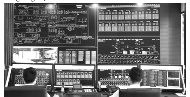
● Trung tâm điều độ Hệ thống điện Hà Nội lập tức triển khai 2 khối điều hành.
