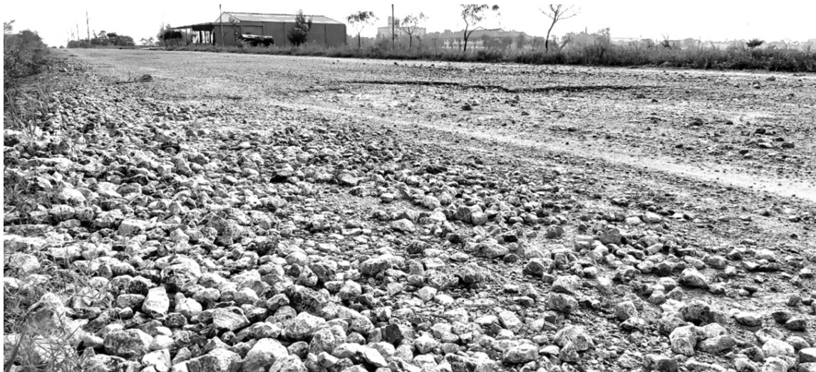
● Một số đoạn đường hư hỏng, xuống cấp.
