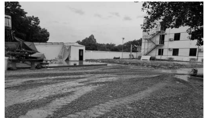
● Phòng khám Hưng Thịnh đã tháo dỡ xong công trình vi phạm phía sau.
