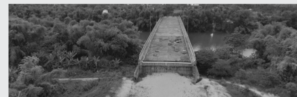
● Một cây cầu xây xong nhưng chưa hoàn thành đường dẫn. (Ảnh: Vũ Anh)
