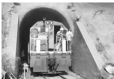
● Ngành Đường sắt vận chuyển trang thiết bị vào điểm sạt lở để khắc phục sự cố. (Ảnh: Phú Khánh)
