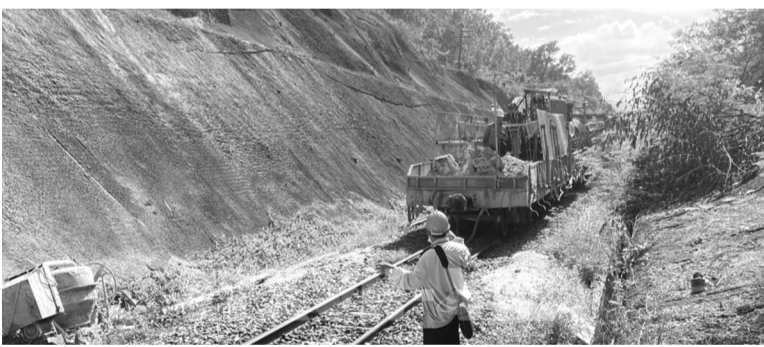
● Vận chuyển vật liệu vào hầm gia cố đoạn sạt lở. (Ảnh: TTXVN)
