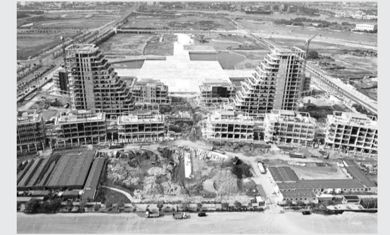
● Dự án Trung tâm Chính trị - Hành chính thành phố Hải Phòng.
