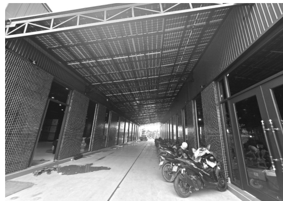
● Sau khi bị UBND huyện Tứ Kỳ xử phạt, công trình vi phạm vẫn tiếp tục thi công, hoàn thiện.
