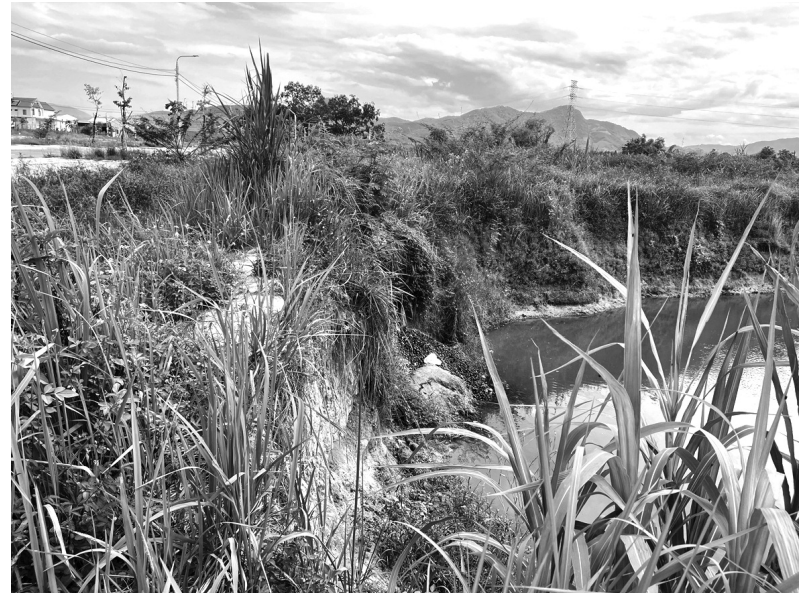
● Sạt lở áp sát đường giao thông khu tái định cư Đồng Giá. (Ảnh: Công Huy)
