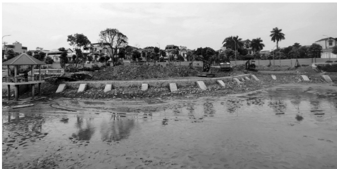
●Khu vực bị sạt lở đang được khắc phục.
