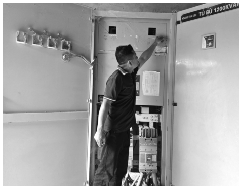
● Một trạm biến áp trong Công ty Ngọc Thảo.
