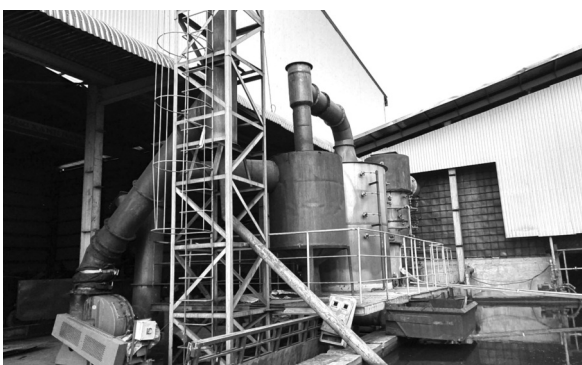
● Xưởng tiếp nhận phân loại và đốt chất thải - Nhà máy xử lý chất thải, tái chế phế liệu Nam Giang. (Ảnh trong bài: Trung Nghĩa)
