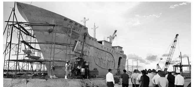
● Tượng đài kỷ niệm chuyển tàu tập kết ra Bắc năm 1954 đang được đẩy nhanh tiến độ xây dựng. (Ảnh: Cổng thông tin Cà Mau)
