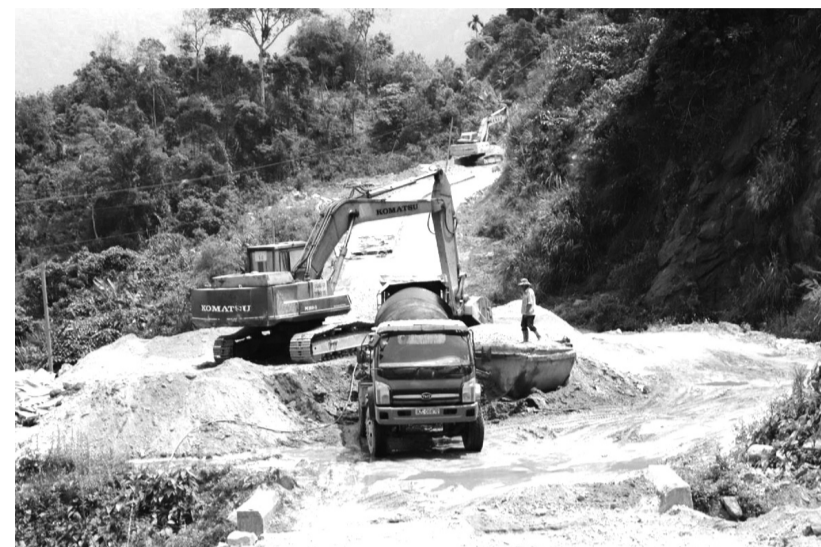
● Sau 3 năm thực hiện, dự án tái thiết các tuyến đường lên 4 xã vùng cao của huyện Phước Sơn vẫn còn ngổn ngang. (Ảnh trong bài: Công Huy)
