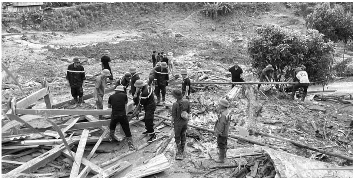
● Hàng chục nghìn ngôi nhà ở Lào Cai bị sập đổ, ngập nước, sụt lún do mưa lũ. (Ảnh: PV)
