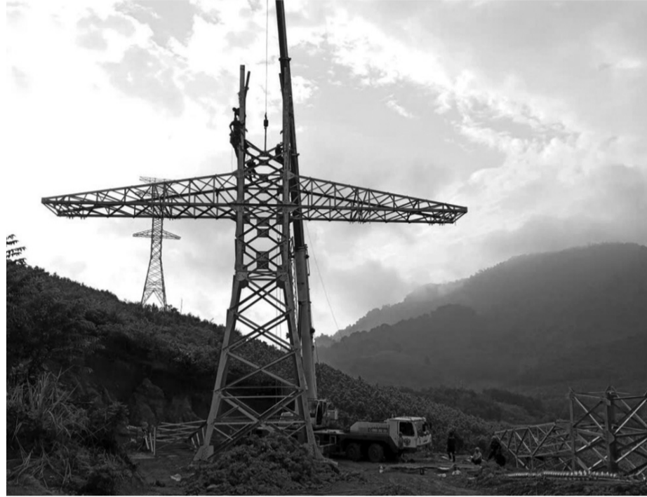
● Dự án đường dây 220kV Nậm Sum - Nông Cống phần đấu hoàn thành trong tháng 10/2024. (Ảnh: EVNNPT)
