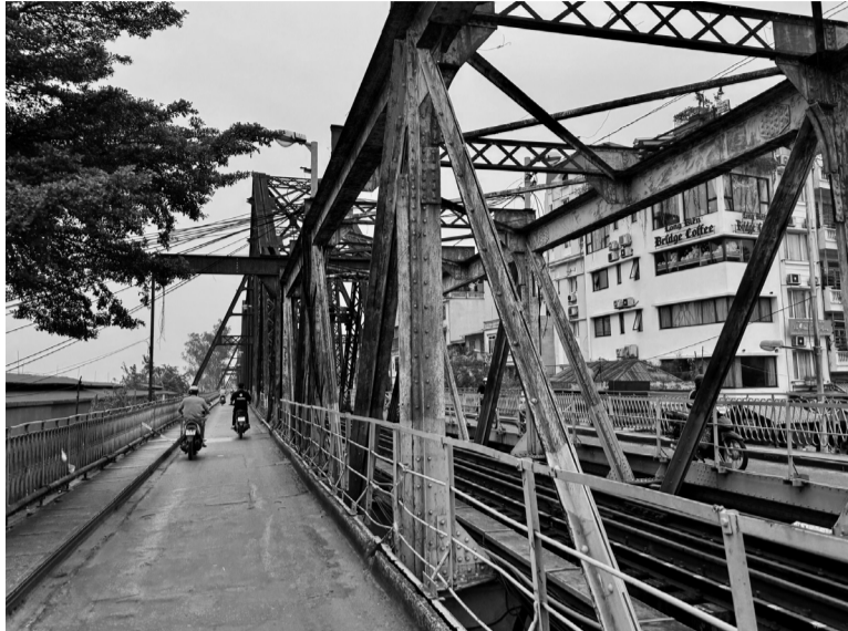
● Nhiều hạng mục trên cầu Long Biên đã xuống cấp nghiêm trọng, gây mất an toàn cho người dân. (Ảnh: PV)
