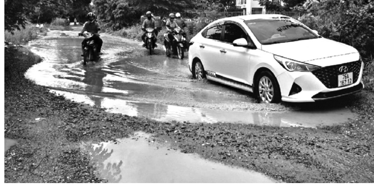
● Mặt đường chỉ chít "ổ gà, ổ voi", vào mùa mưa nước ngập, tiềm ẩn tai nạn giao thông. (Ảnh trong bài: Anh Huy)
