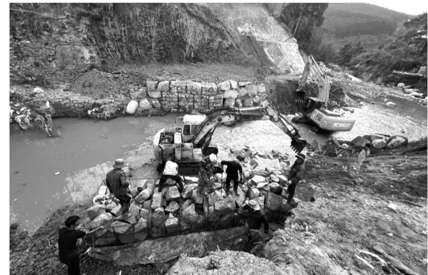
● Một góc công trường dự án Nhà máy thủy điện Cam Ly. (Ảnh: Mai Long)
