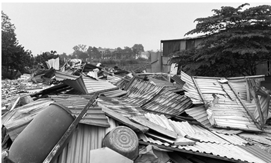
● Công trình vi phạm của ông Trường bị UBND xã Chàng Sơn cưỡng chế phá dỡ khi chưa thiết lập đầy đủ hồ sơ xử lý vi phạm hành chính. (Ảnh: Ban đọc cung cấp)
