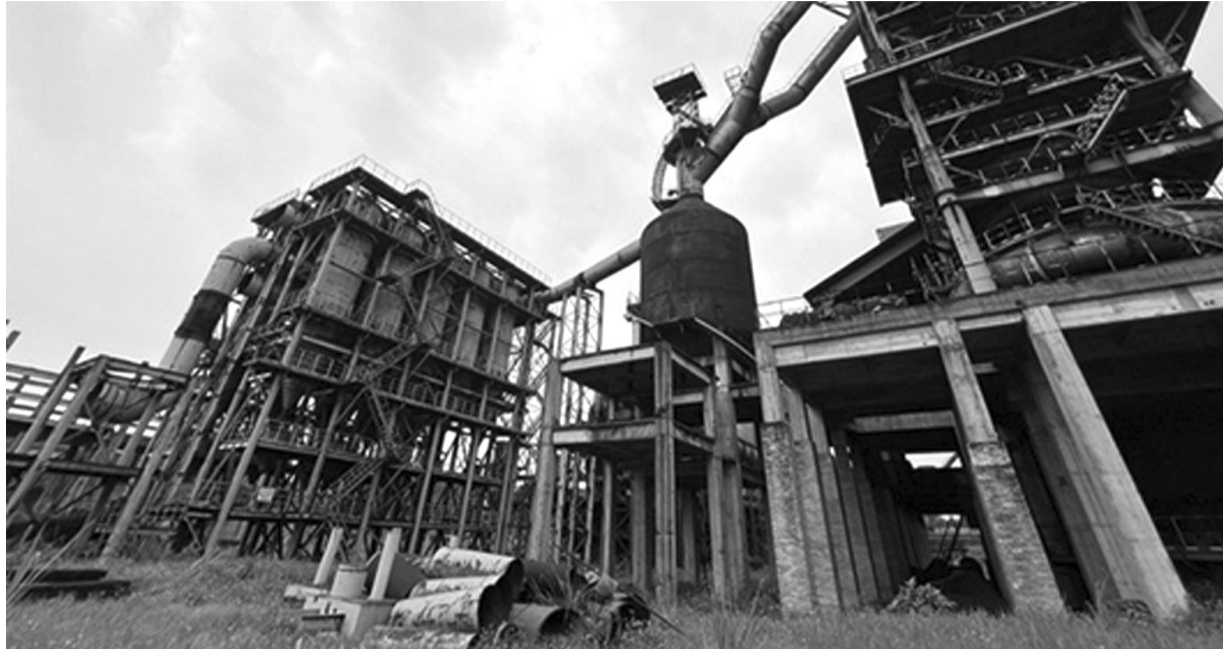
● Dự án TISCO2 tạm dừng thi công từ năm 2013 đến nay. (Ảnh: CTV)
