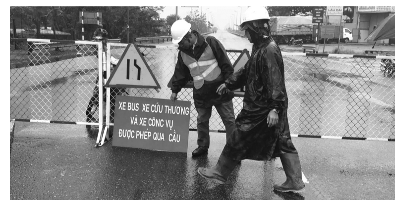
● QL1A đứt đoạn đoạn qua cầu Cầu Lâu mới từ 23/12/2024.
