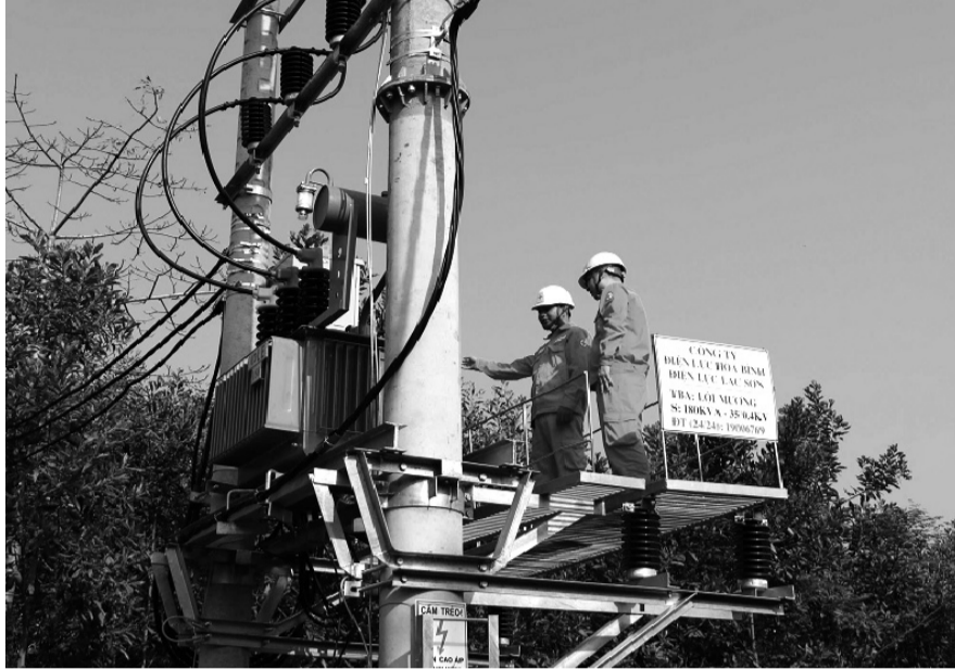
● EVNNPC đầu tư nhiều trạm biến áp mới để nâng cao độ tin cậy cung cấp điện ở miền Bắc. (Ảnh: EVNNPC)
