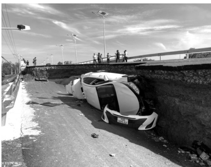
● Hiện trường vụ việc sụp lún đường tại Tây Ninh.
