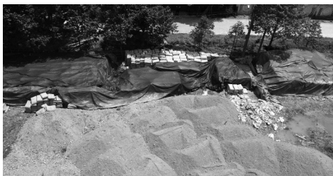
● Hơn 200 tấn xi măng đông cứng vì không được bảo quản tốt được tập kết tại sân vận động xã Lộc Yên. (Ảnh: Hữu Anh)
