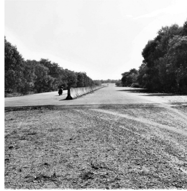
●Đoạn đường trục chính vào KCN Tam Thăng mở rộng thi công nhiều năm nhưng vẫn chưa hoàn tất.
